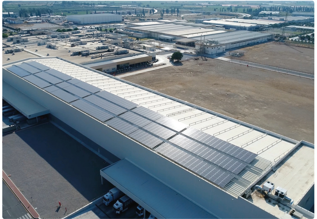
514kWp solar FV sistemi, JTİ'nin Torbalı'daki lojistik merkezinin çatısına kuruldu
