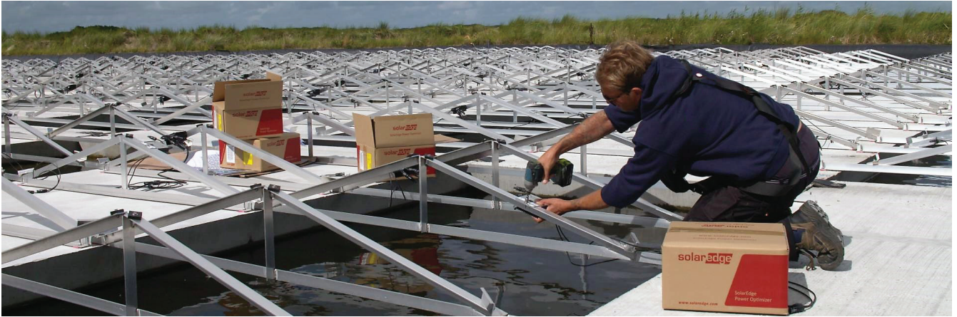
PV 설치물은 빗물 저수지 위에 걸쳐 있는 콘크리트 다리에 고정되어 있습니다.
