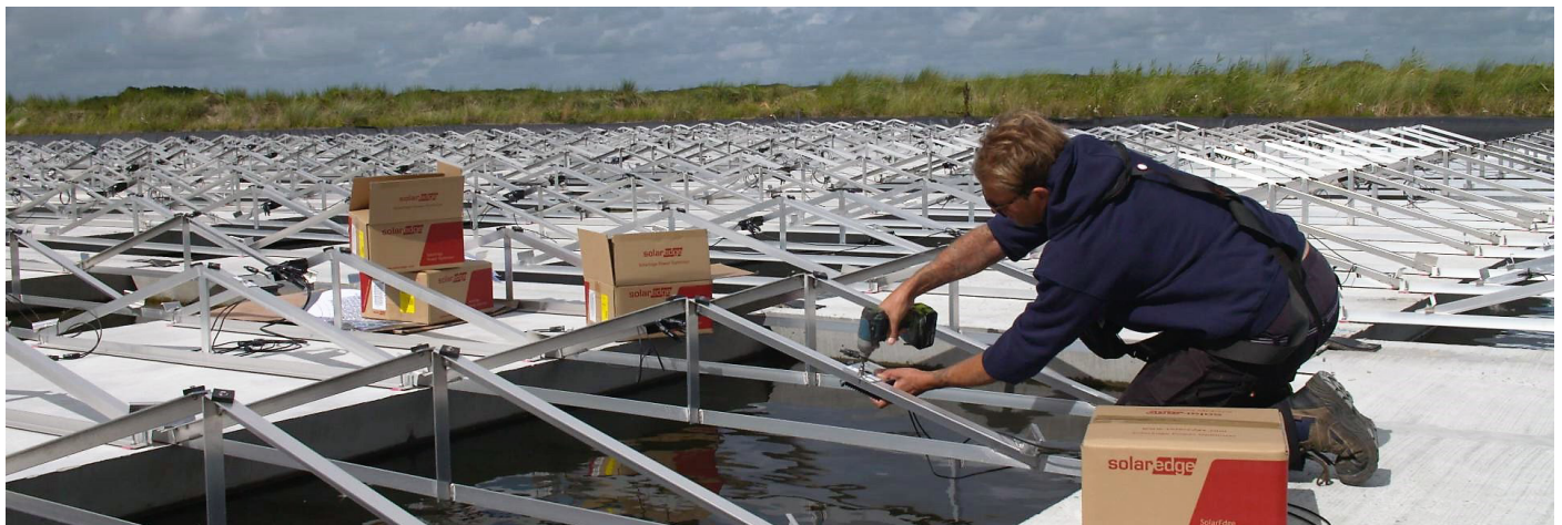
太陽光発電設備は、貯水池上方部のコンクリートポンツーン上に設置されました。
