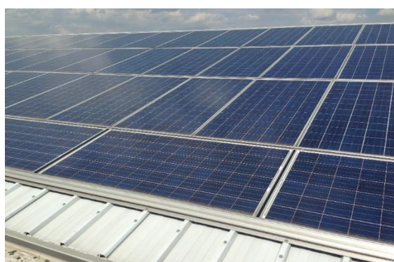
Figuur-3: Foto van string 15.2 onthult geen duidelijk oorzaak voor mismatch tussen de zonnepanelen in de string.
