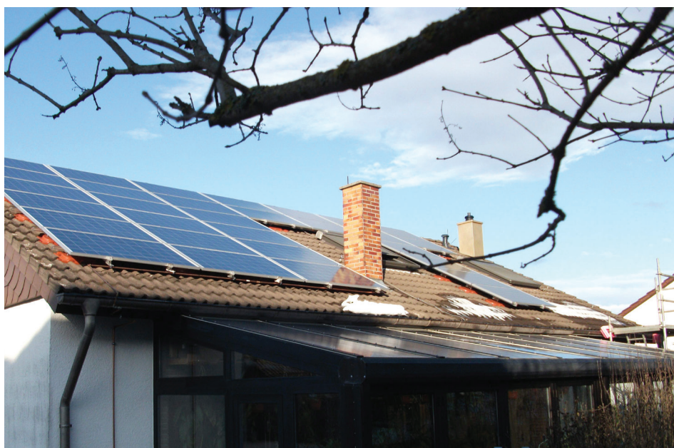
La foto mostra in che modo il sistema SolarEdge ha consentito al Sig. Schneider di installare i moduli vicino al comignolo senza rischiare perdite di energia sproporzionate.
