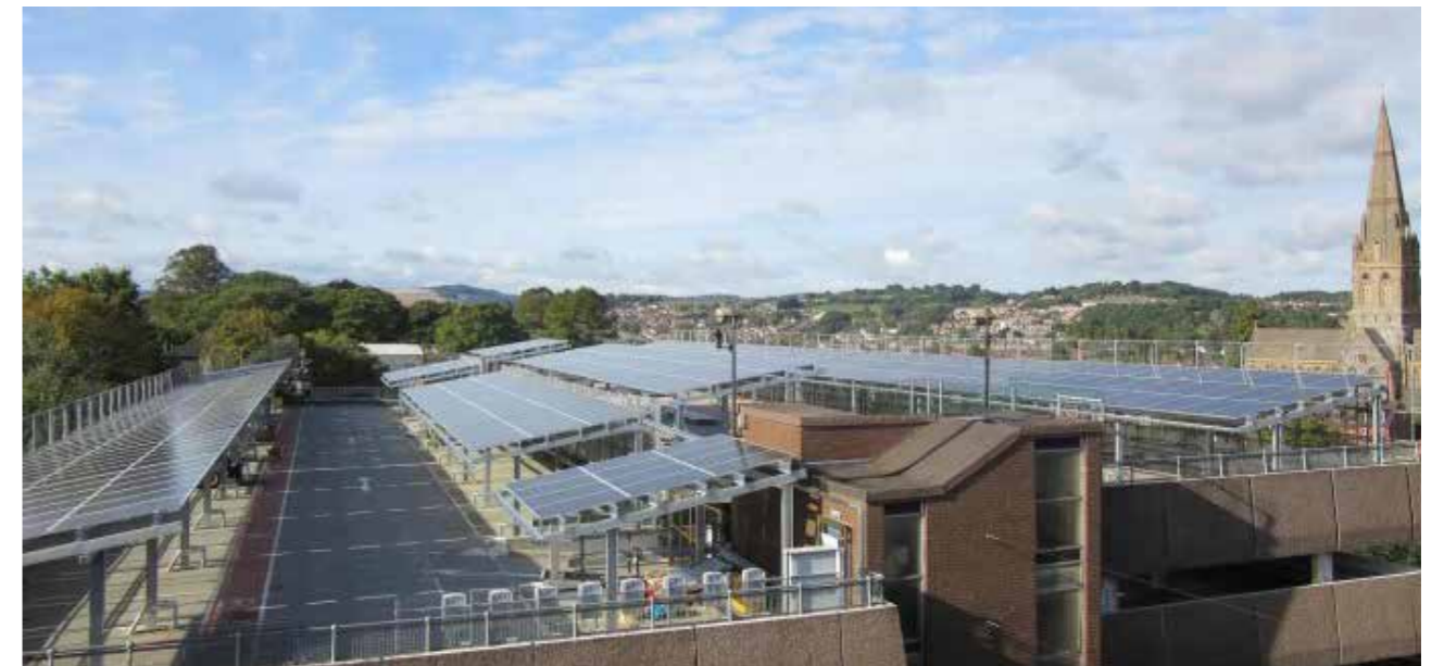
Reino Unido, 150kW Aparcamiento John Lewis, Exeter
