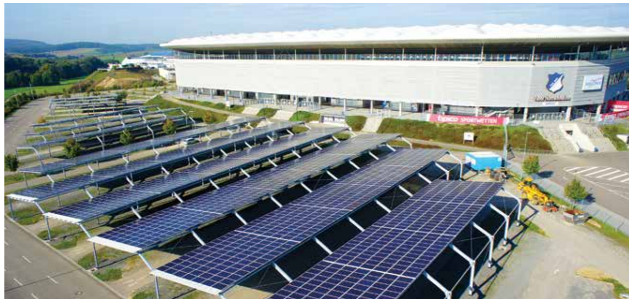
Alemanha, 1MW Estacionamento do Estádio TSG Hoffenheim, Sinsheim
