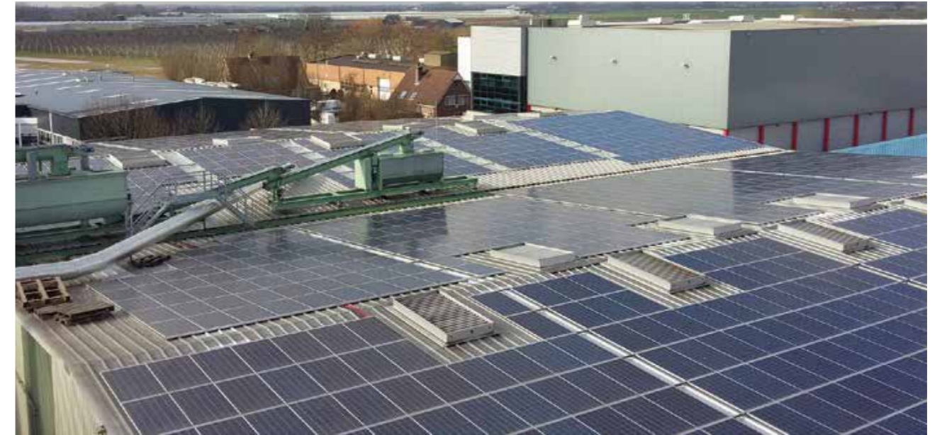
Nederland (2,4 MW) Plospan Waardenburg, houtverwerking
