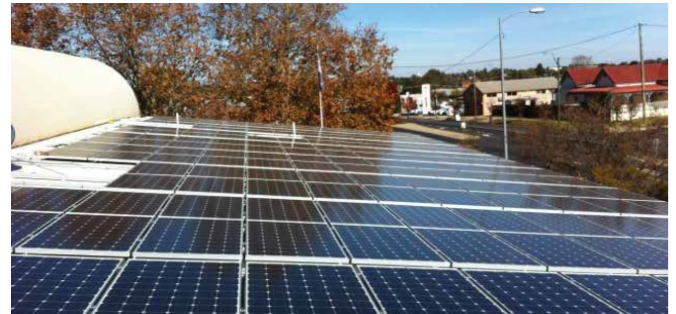
Australia, 100 kW Parkes Shire Council, Nuovo Galles del Sud
