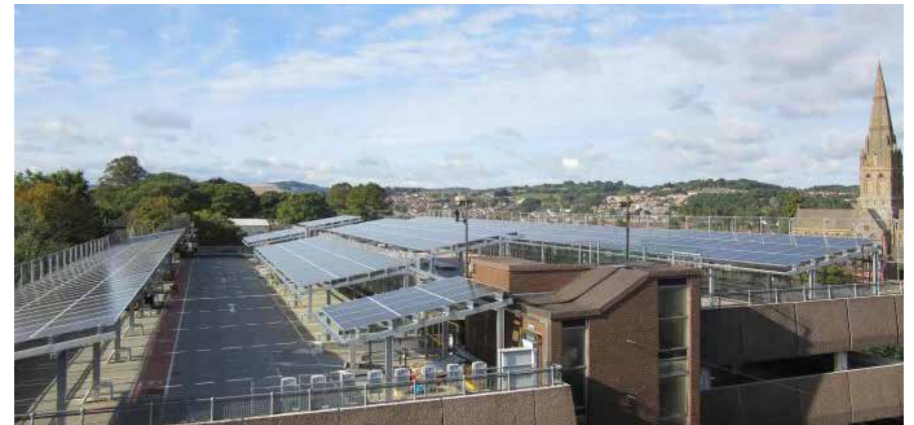
Großbritannien, 150 kW John Lewis-Parkhaus, Exeter
