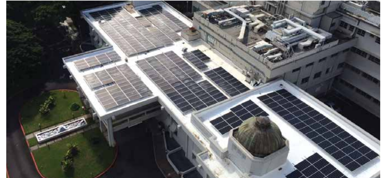
美國, 220KW 夏威夷州 Kuakini 醫院
