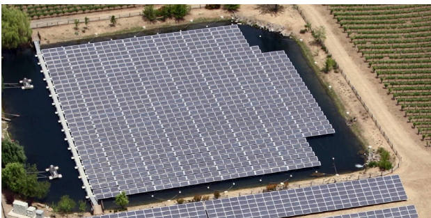
ソーラーエッジ水上太陽光発電システム、米国、386kW
