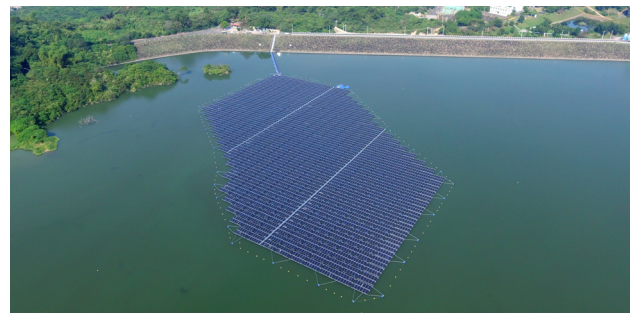
SolarEdge水面型系統，2MW，高雄鳳山水庫
