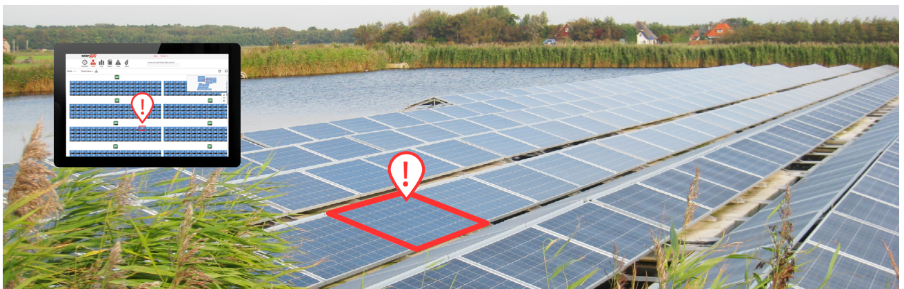
SolarEdge水面型太陽能系統，荷蘭，232KW
