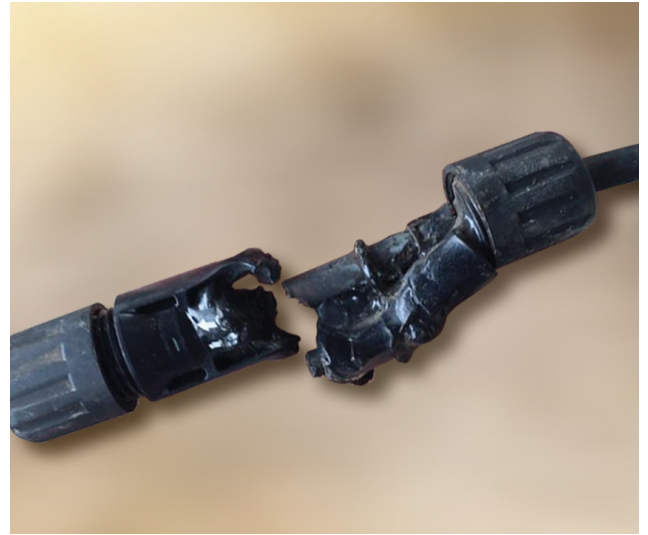
รูปที่ 6: คอนเนคเตอร์ MC4 ที่เสียหายจากการเกิดอาร์ค
