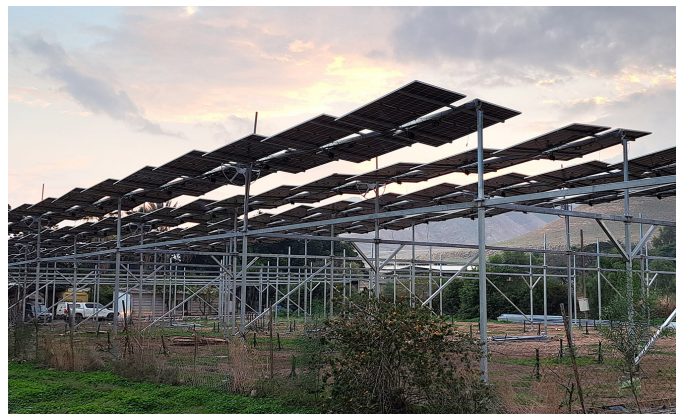
採用SolarEdge太陽能追日系列的架高結構
