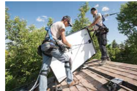
SolarEdge w domu
