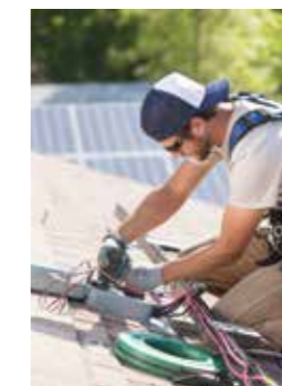
De kracht van zonne-energie
