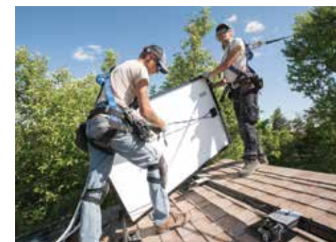
Les solutions SolarEdge s'adaptent partout
