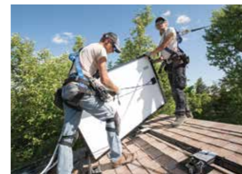
Les solutions SolarEdge s'adaptent partout
