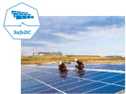
Safe DC skyddar installatörer från högspänning
